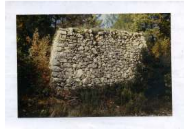
Borie ruinée du chemin de Trempasse D.62
